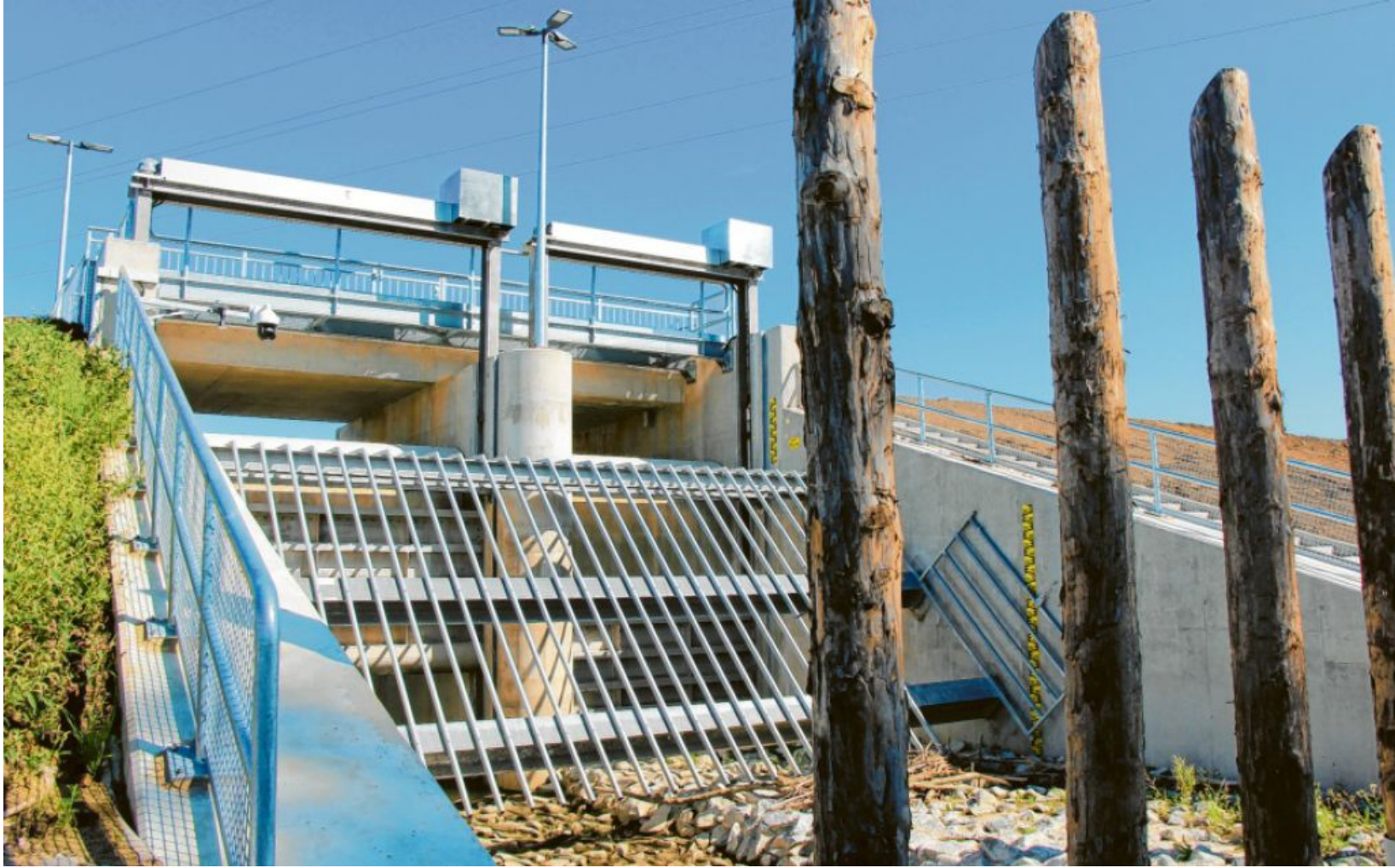
Das Hochwasserrückhaltebecken in dem Merchinger Ortsteil Steinach ist im Grunde fertiggestellt. Es stehen aber noch Arbeiten an den Wegen auf und neben dem Damm an. Der Durchlass ist das Herzstück der Anlage.
